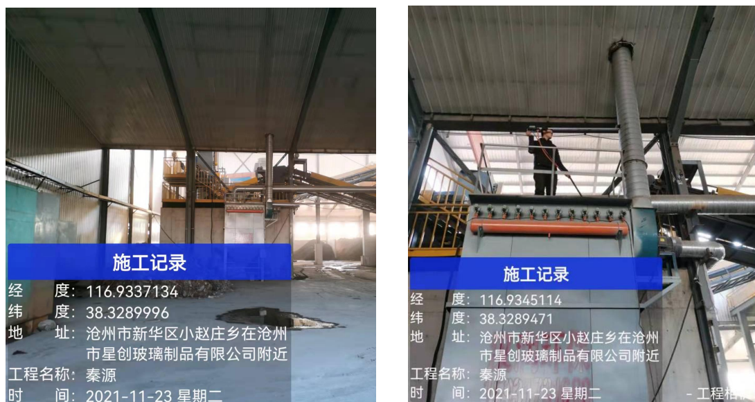
布袋除尘器+排气筒
