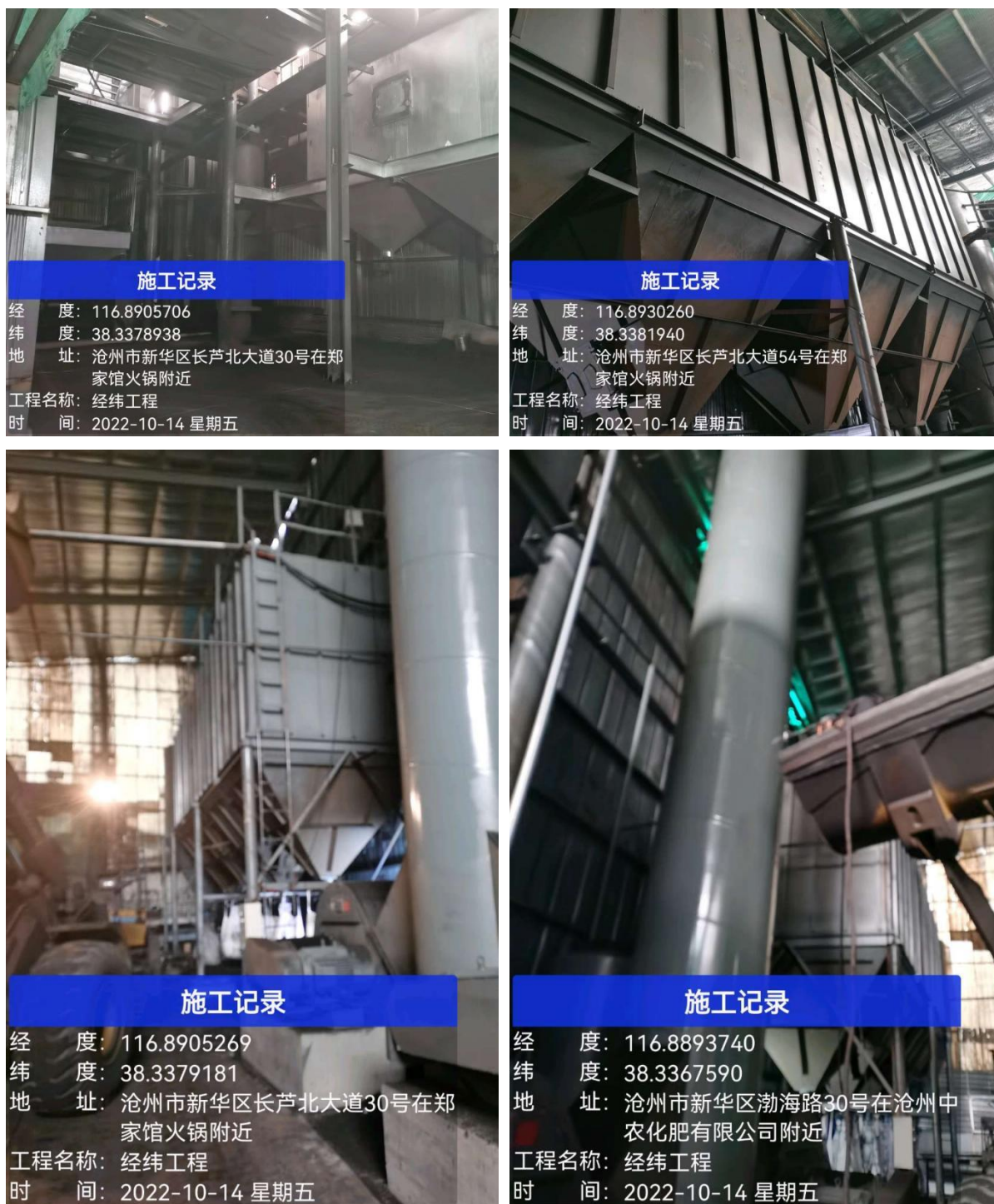
图 3-1 废气治理设施现场图
