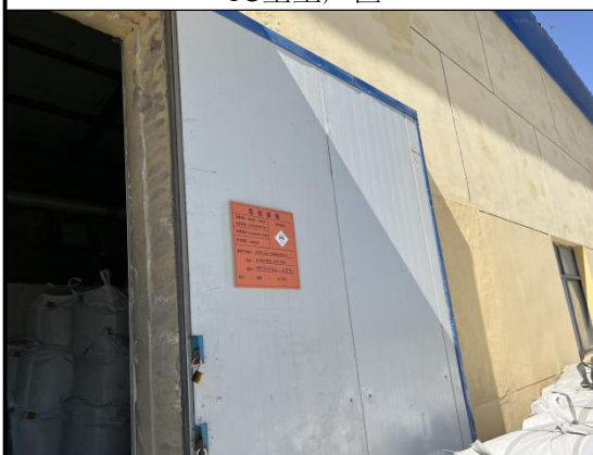
1F飞灰暂存间、危废间
