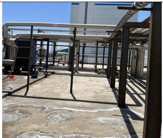
1A污水处理站
