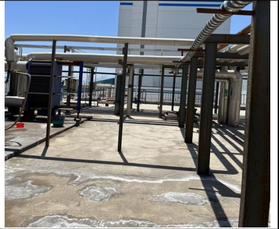
1A污水处理站
